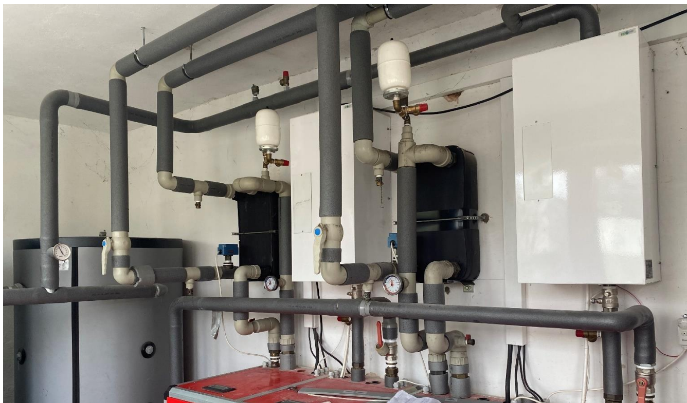
Obrázok 5: Pohľad na elektro kotle – MŠ Rusovce
