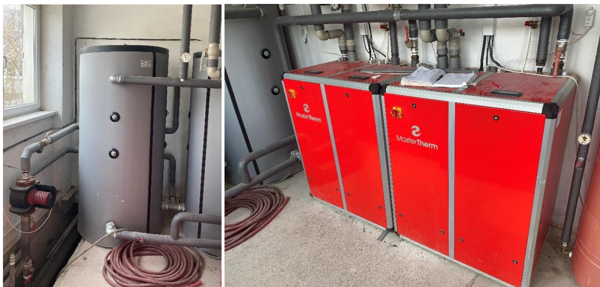
Obrázok 4: Pohľad na strojovňu tepelných čerpadiel
